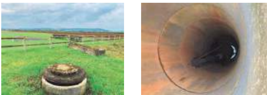
Photo 4 (vues a/b) : Ancien puisard encombré
