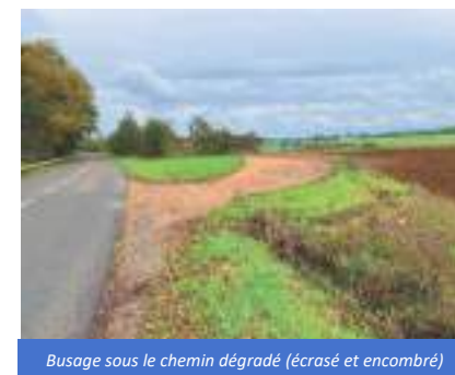
Busage sous le chemin dégradé (écrasé et encombré)
