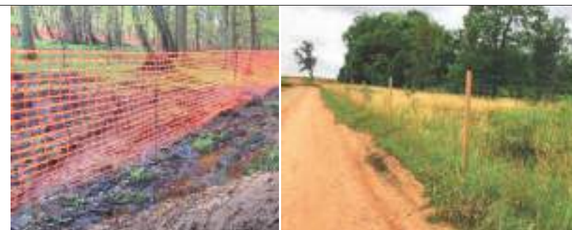
Figure 192 : Exemple de balisage temporaire en phase chantier et de balisage pérenne en phase exploitation (Source : Rainette)
