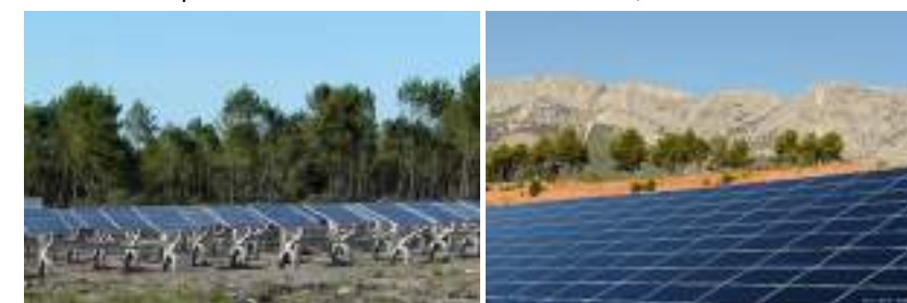
Figure 3 : Structures solaires (à gauche : les trackers de la centrale de Gabardan (40) qui suivent le soleil ; à droite : structures fixes à Puylobier (13)) - Source : EDF Renouvelables
